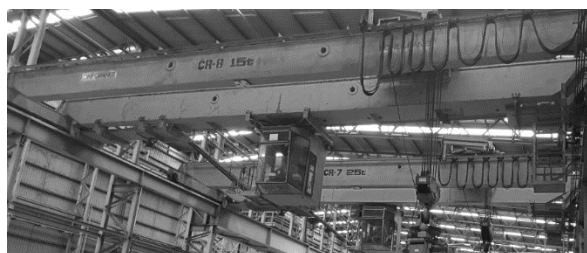
ภาพที่ 1 ห้องควบคุมปั้นจั่นเหนือศีรษะ
